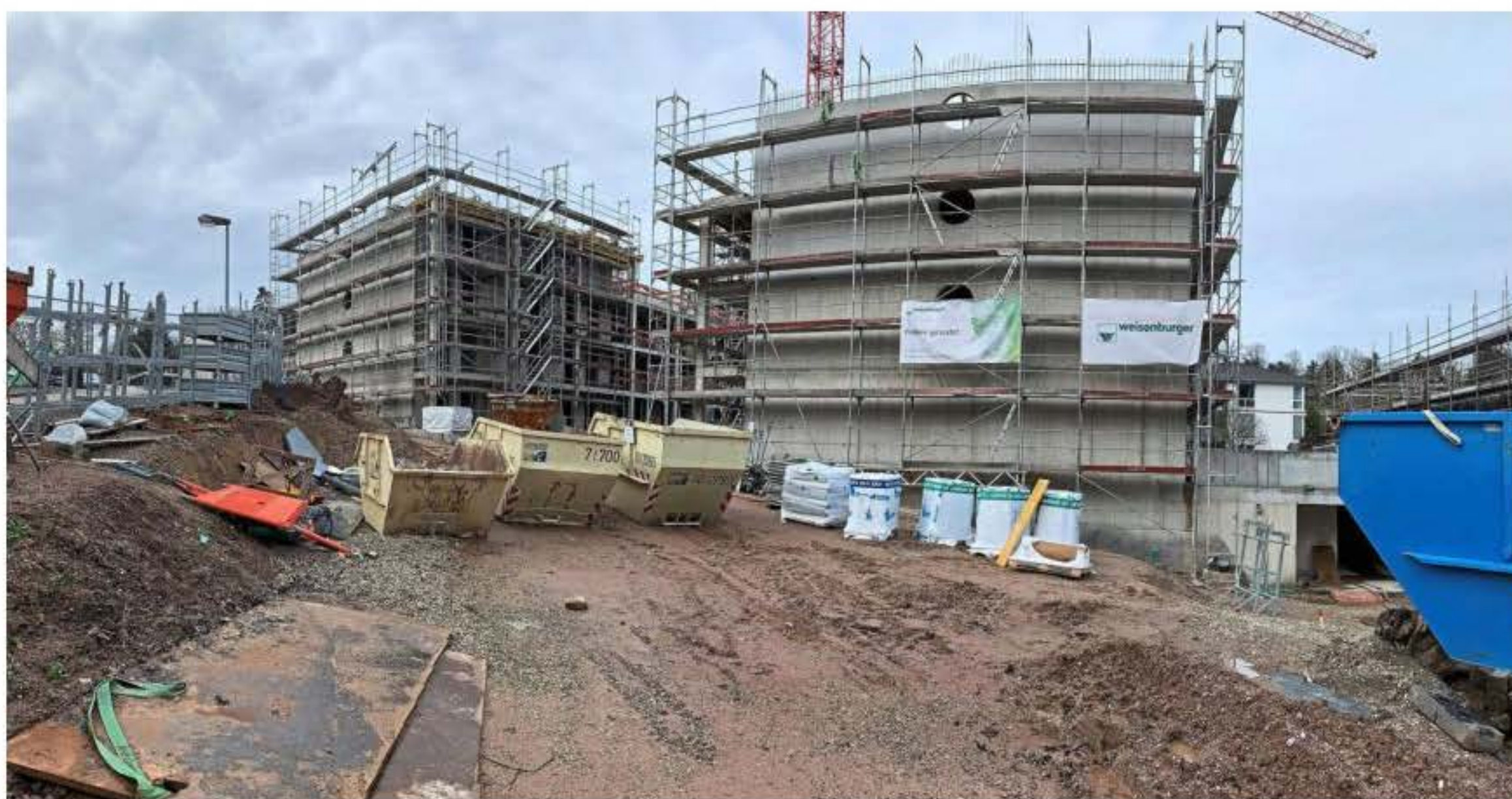
Sichtbarer Bau-Fortschritt: Die ersten beiden Wohngebäude wachsen in die Höhe. Bereits im November sollen die ersten Eigentümer einziehen können. Fotos: Bernd Kappler
