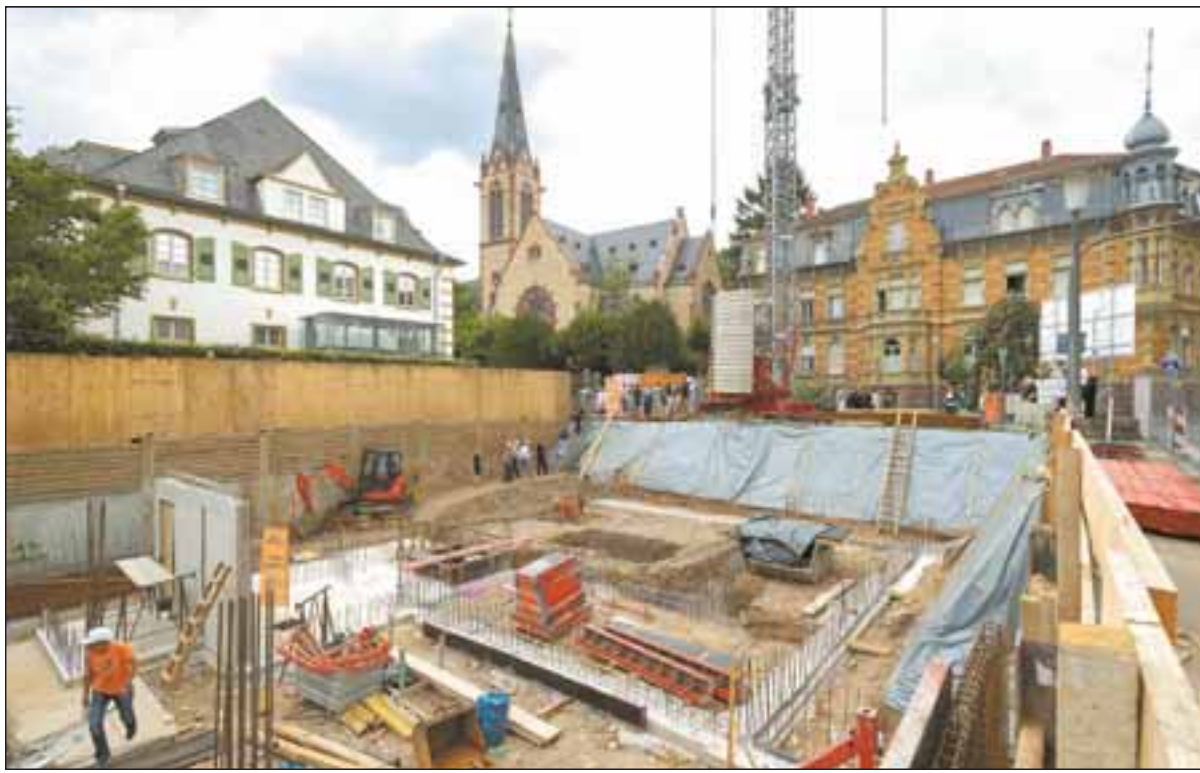
An der Ecke Lutherstraße/Schröderstraße stand bis vor Kurzem das ehemalige Dekanatshaus der evangelischen Kirche. Nun entstehen dort zwei neue Häuser mit drei und vier Geschossen. Foto: Philipp Rothe
